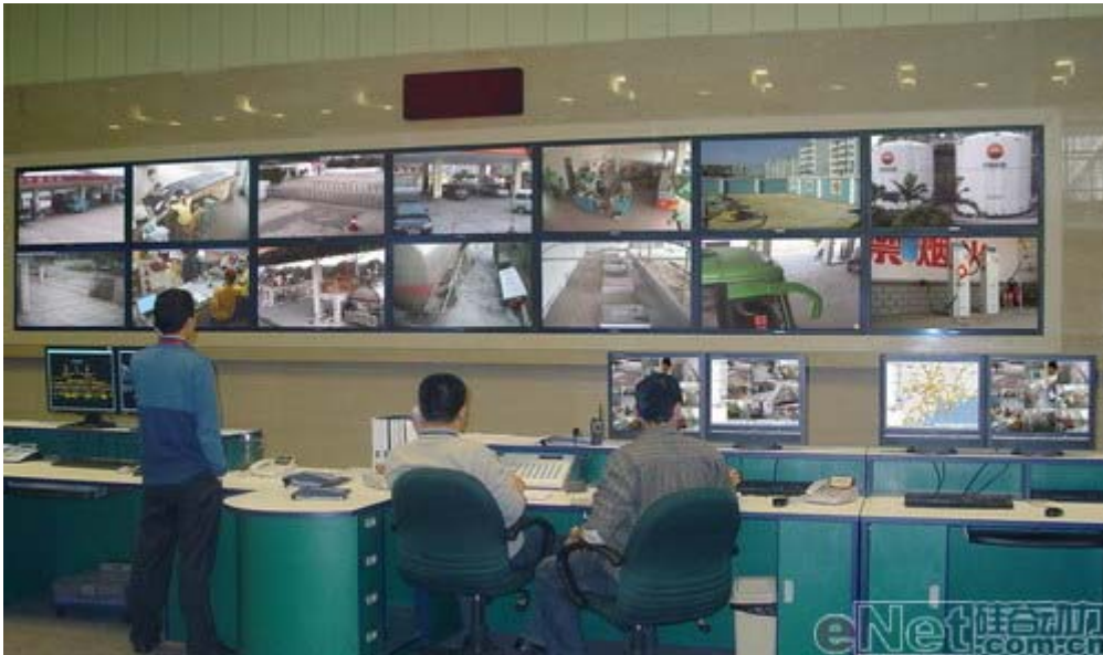
中石油使用 AVCON“監控+會議”一體化監控系統現場
